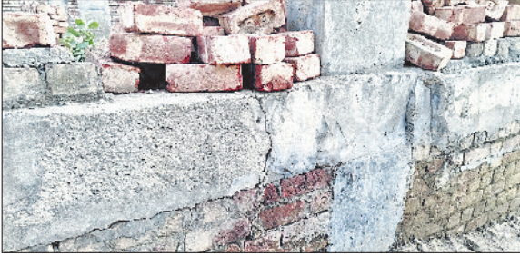
कलायत। पुराने निर्माण की धंसी नींव व क्रेक हुए बीम पर जारी नव निर्माण।
